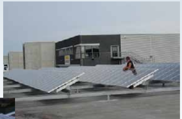
Aufgeständerte Module auf einem Flachdach
